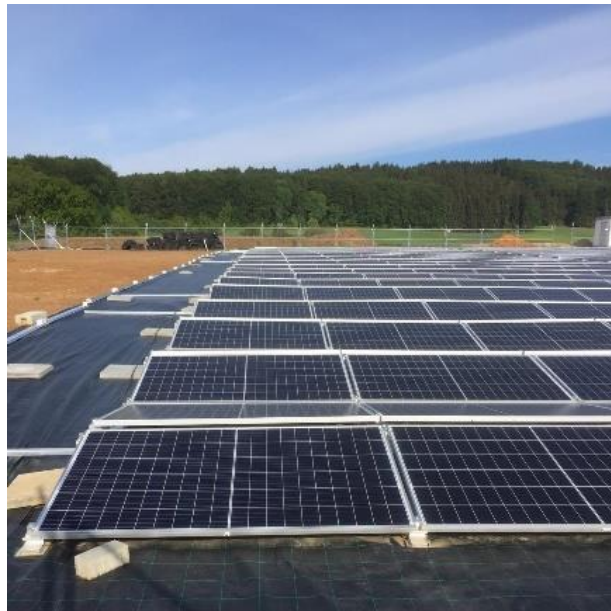
Abbildung 32: Beispiel einer bodennah angebrachten PV-Anlage in Ost-West-Ausrichtung
