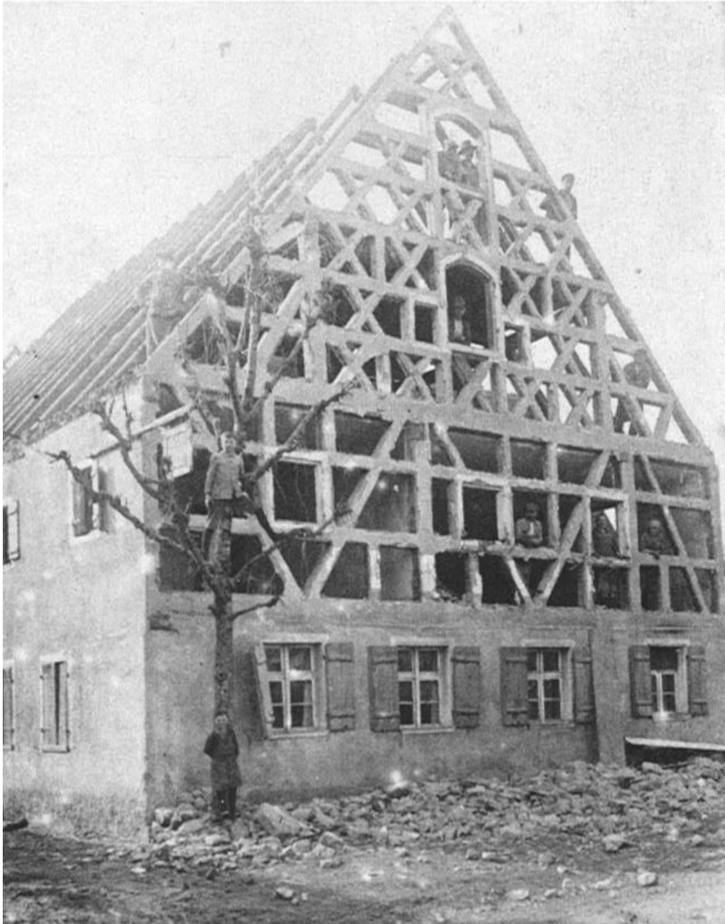
Der Gasthof Glauber abgerissen (der Brandenburgische Wirt „Zum Goldenen Löwen“) wurde 1929 trotz des prächtigen Schmuckfachwerks abgerissen.
