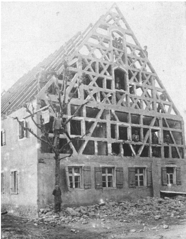
Der Gasthof Glauber (der Brandenburgische Wirt „Zum Goldenen Löwen“) wurde 1929 trotz des prächtigen Schmuckfachwerks abgerissen. VU S. 84
